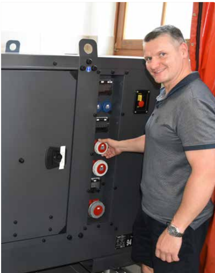
Bgm. Hans-Peter Pachler, im Fall eines Blackouts Einsatzleiter in Innerschwand, inspiziert das Notstromaggregat, das im Feuerwehrhaus Loibichl untergebracht ist und die Einsatzzentrale im Notfall mit Strom versorgt. Foto: Gemeinde
