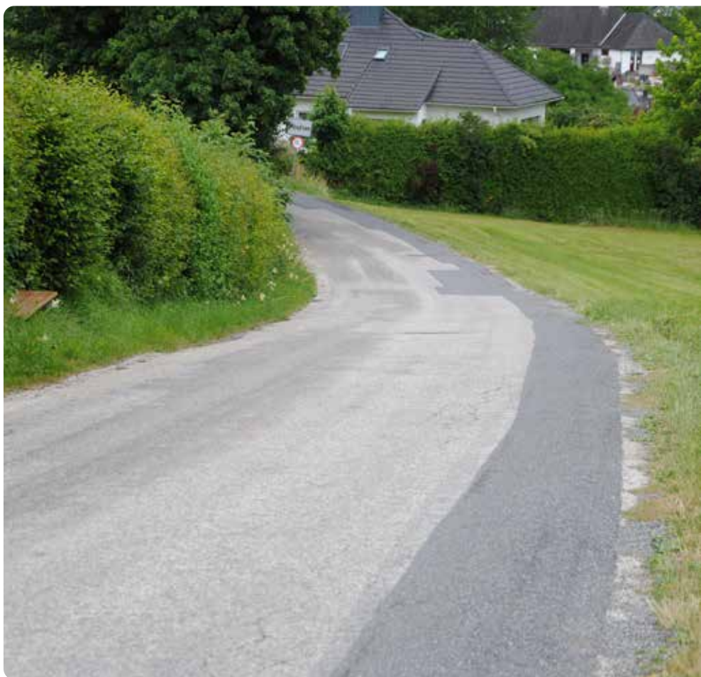
Der Gehsteig entlang der Gaisbergstraße wird verlängert. Vom Haus Ganisl wird das Teilstück bis zur Gemeindegrenze Mondsee errichtet. Foto: Gemeinde
